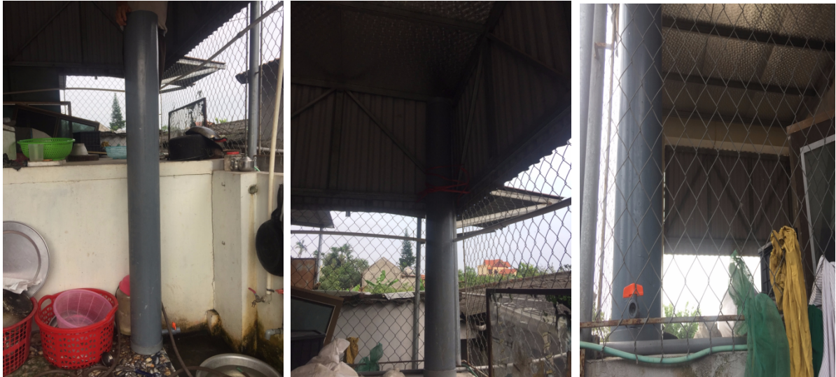
Hình 44 Hình ảnh hệ thống lọc nước mưa thành nước sinh hoạt có công suất 120L
