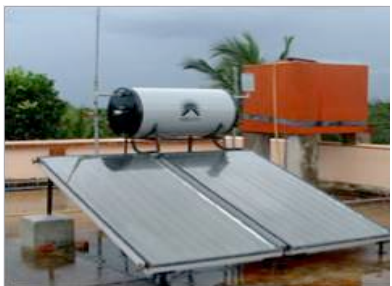
Thiết bị đun nước nóng sử dụng năng lượng mặt trời
