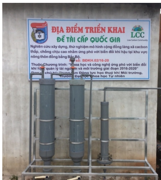
Hình 23 Hệ thống xử lý loại bỏ CO_2 và H_2S trong khí biogas
