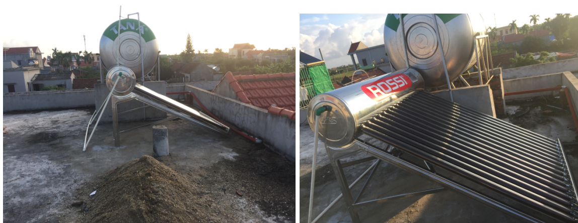
Hình 46 Hệ thống đun nóng nước bằng bức xạ mặt trời thực tế
