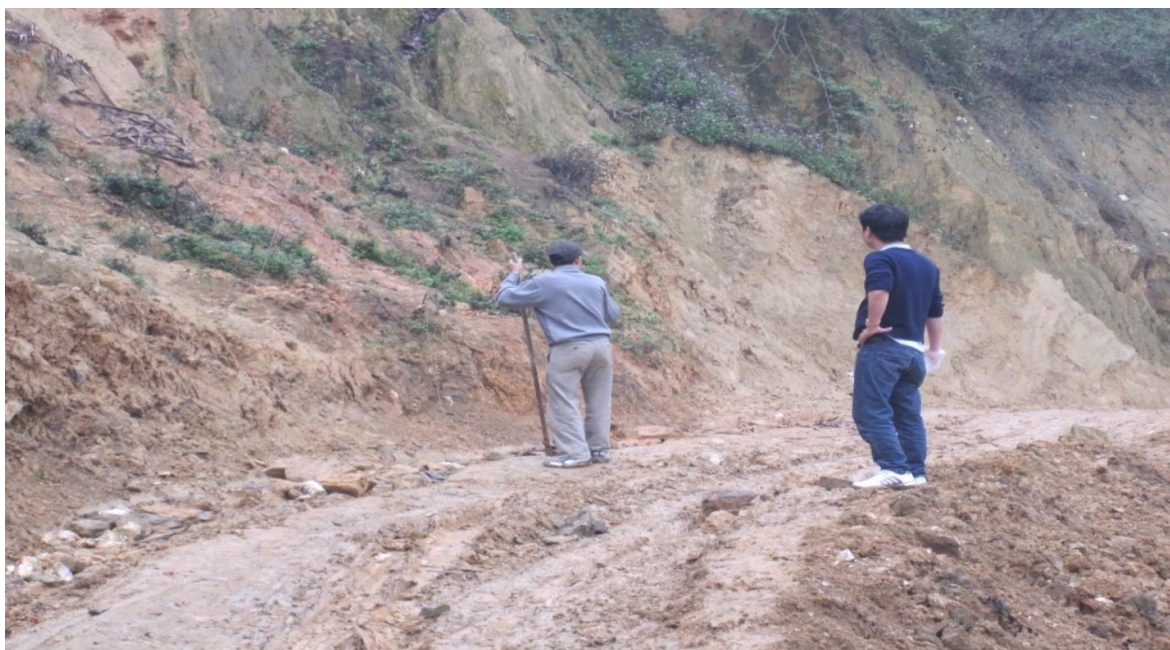
Hình 14: Sạt lở sau mưa trên đường đi tại xã Quang Thành, huyện Nguyên Bình, tỉnh Cao Bằng
