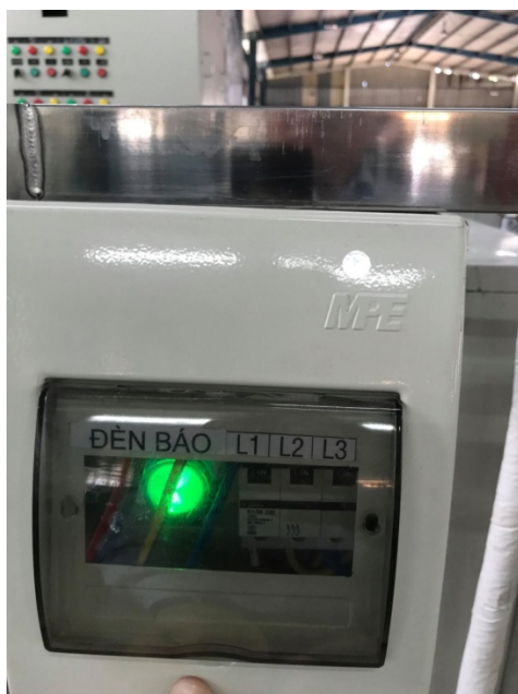
Hình 3.55: Module nguồn điện cấp cho hệ thống.
