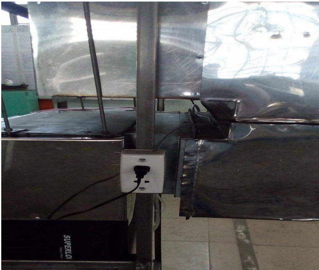
Hình 3.20: Nguồn cấp cho bơm của hệ thống RO.
