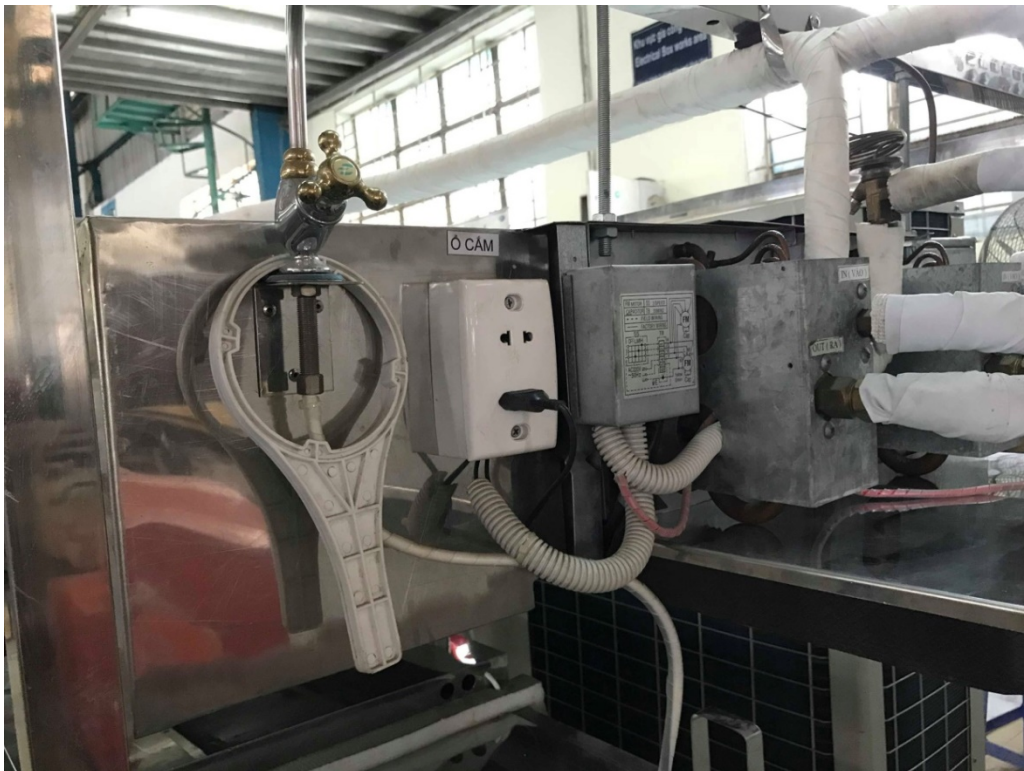
Hình 3.54: Nguồn cấp cho bơm của hệ thống RO.
