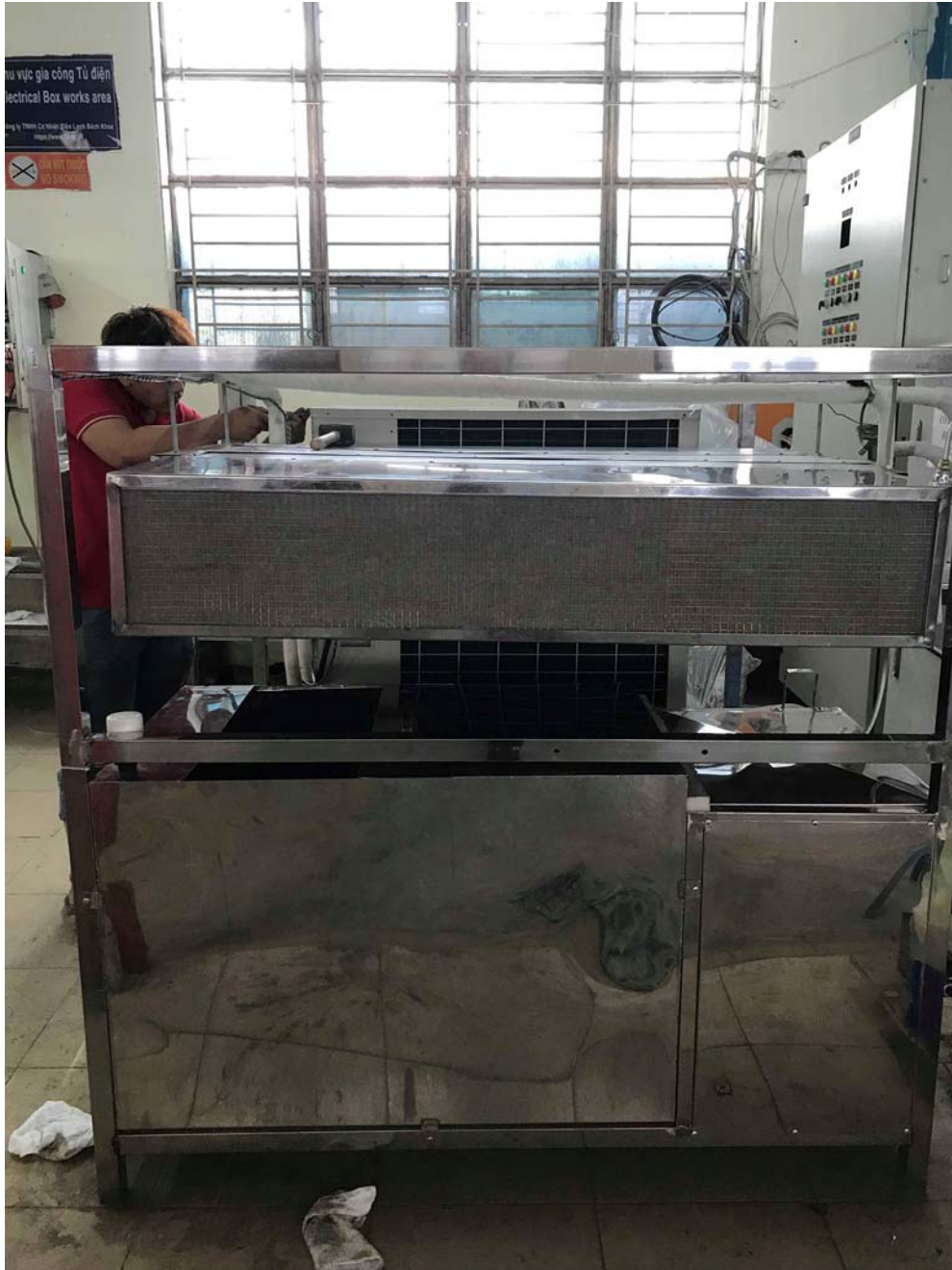
Hình 3.52: Mặt trước của hệ thống thiết bị tách âm công suất 200L/ngày.
