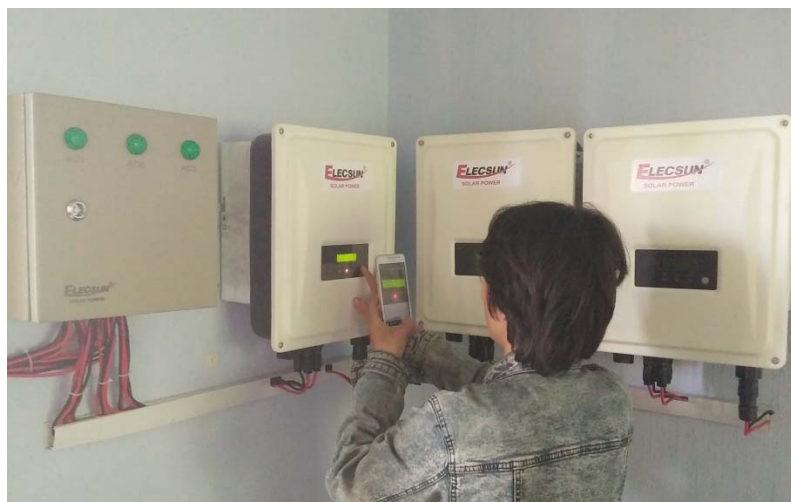
Hình 3.72: Hệ thống điều khiển nguồn cung cấp năng lượng mặt trời
