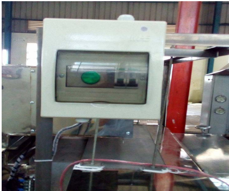
Hình 3.18: Module nguồn điện cấp cho hệ thống.
