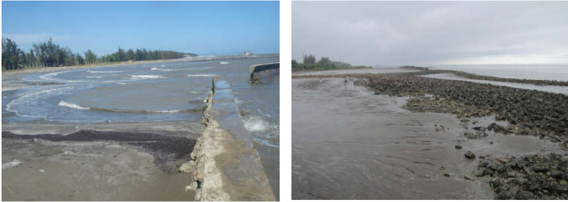
Hình 3.33. Công trình kè bảo vệ bờ Đông Hòa, Cần Giờ được xây dựng từ trước năm 2002 (trái) và đã bị phá hủy, chỉ còn lại đá móng (phải) (ảnh Vũ Văn Phái, 2009 và 2012)
