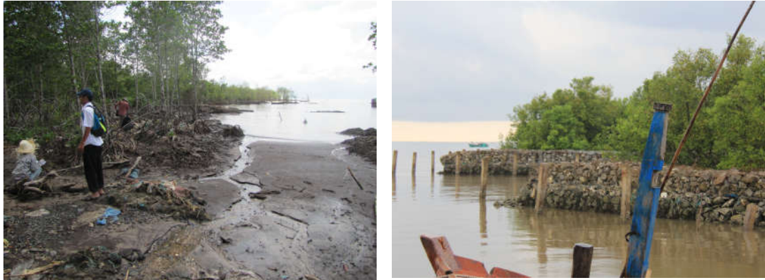
Hình 3.45. Xói lở bờ biển phía trong hòn Đá Bạc (trái) và ở xã Khánh Bình Tây (phải) (ảnh Vũ Văn Phái, 2012)
