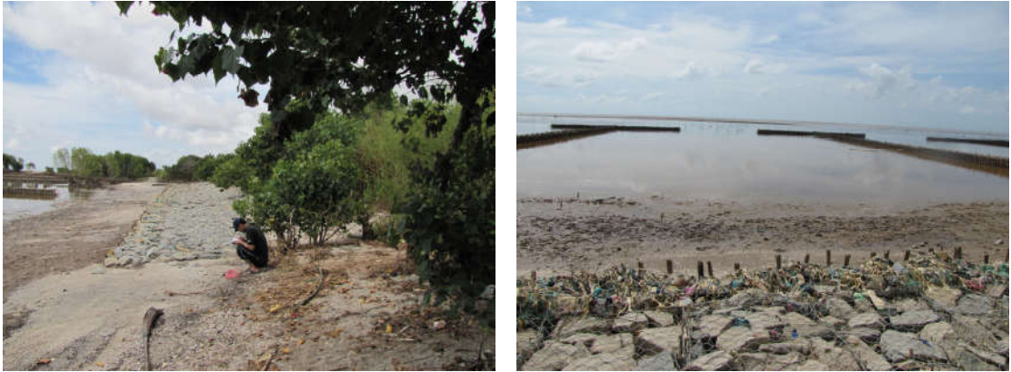
Hình 3.39. Bờ biển xói lở vào sát chân đê (trái) và kè chữ T bằng tre để bảo vệ bờ (phải) ở Vĩnh Tân, huyện Vĩnh Châu, tỉnh Sóc Trăng (ảnh Vũ Văn Phái, 2012).
