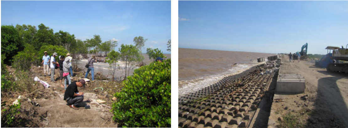
Hình 3.34. Bờ biển huyện Gò Công Đông (Tiền Giang) đang bị xói lở mạnh làm mất dải rừng ngập mặn (trái) và có đoạn đã tiến sát vào chân đê phải xây dựng công trình bảo vệ (ảnh Vũ Văn Phái, 2012)
