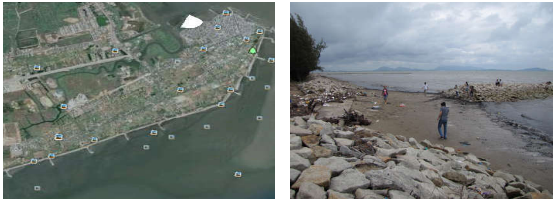
Hình 5.24. Kè mở ở phía đông bắc bờ biển huyện Cần Giờ, TP. Hồ Chí Minh ảnh Vũ Văn Phái 2012 (phải) và Google Earth (trái)
