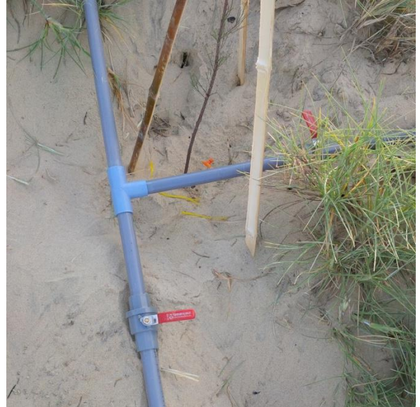
b) Hệ thống van điều khiển nước
