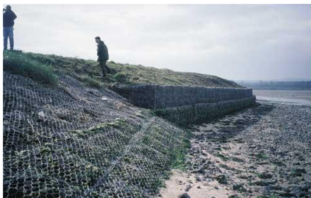
Hình 5. 14. Bố trí rọ đá xếp theo dạng mái hoặc theo dạng tường đứng thấp (lộ rọ đá)
