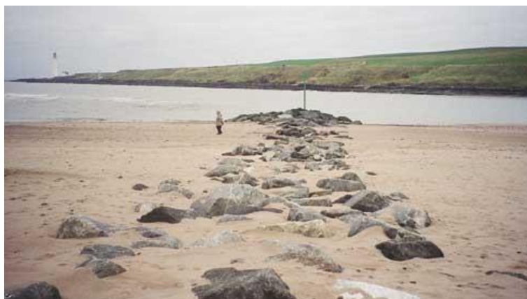
Hình 5. 11. Mở hàn vừa được xây dựng, kết hợp với giải pháp nuôi tạo bãi biển liền kề
