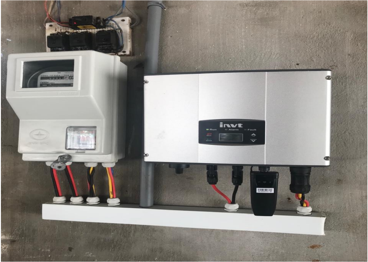
Hình 5. 32. Hệ thống hộp điện
