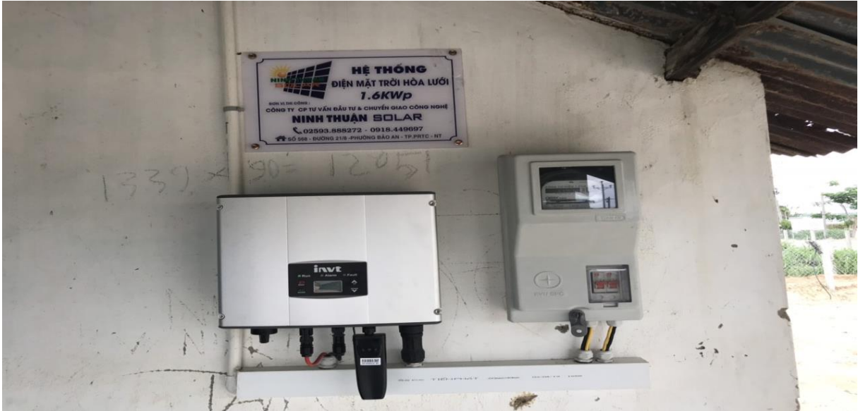
Hình 5. 20. Hệ thống hộp điện cung cấp điện năng cho hệ thống tưới tiêu
