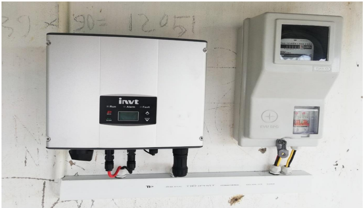
Hình 5. 8. Hệ thống hộp điện
