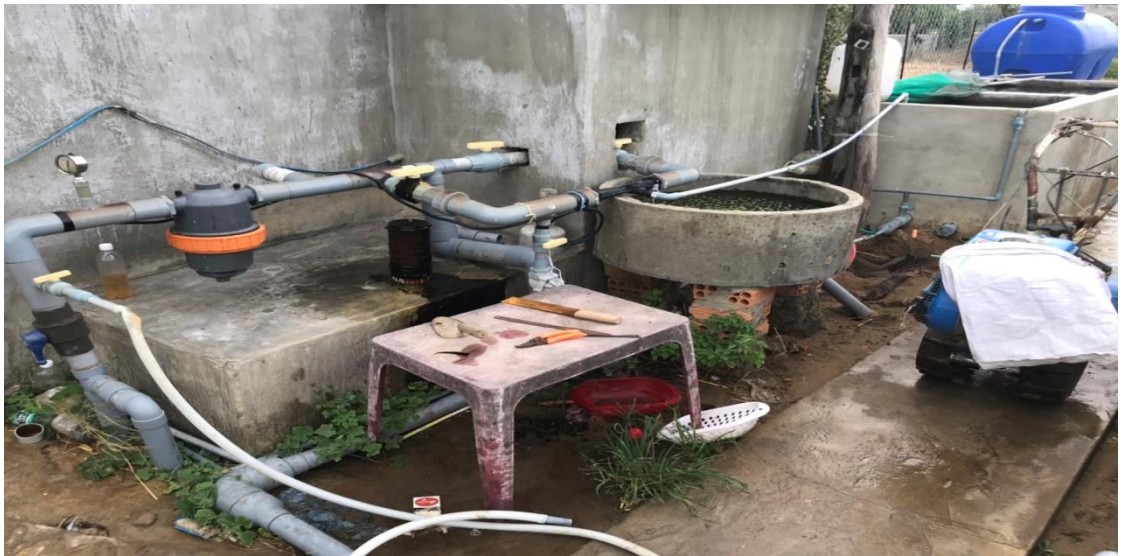
Hình 5. 4. Hệ thống bơm nước
