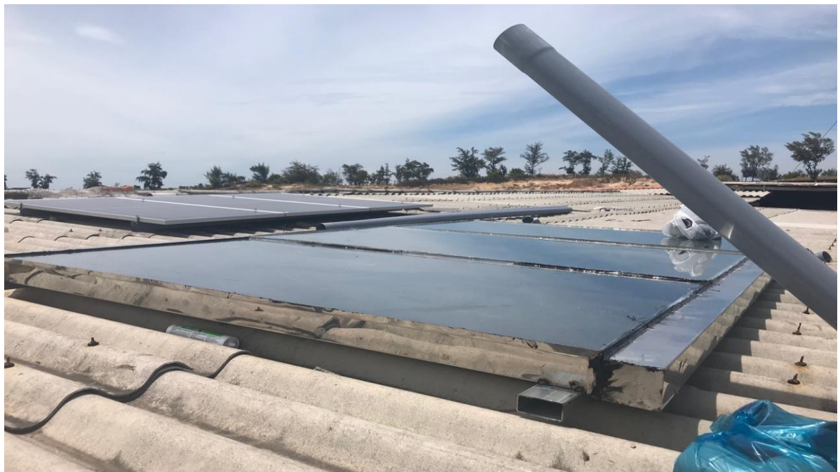
Hình 5. 31. Các tấm pin năng lượng mặt trời được lắp đặt
