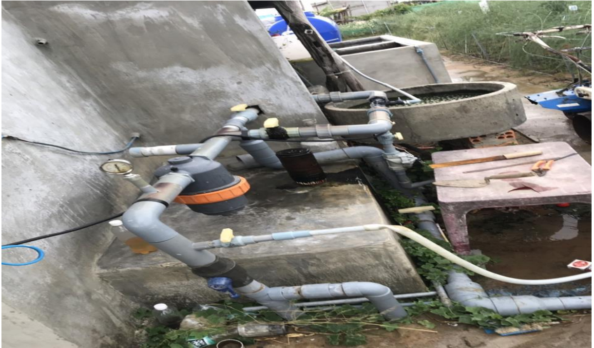
Hình 5. 16. Hệ thống máy bơm và các đường ống dẫn
