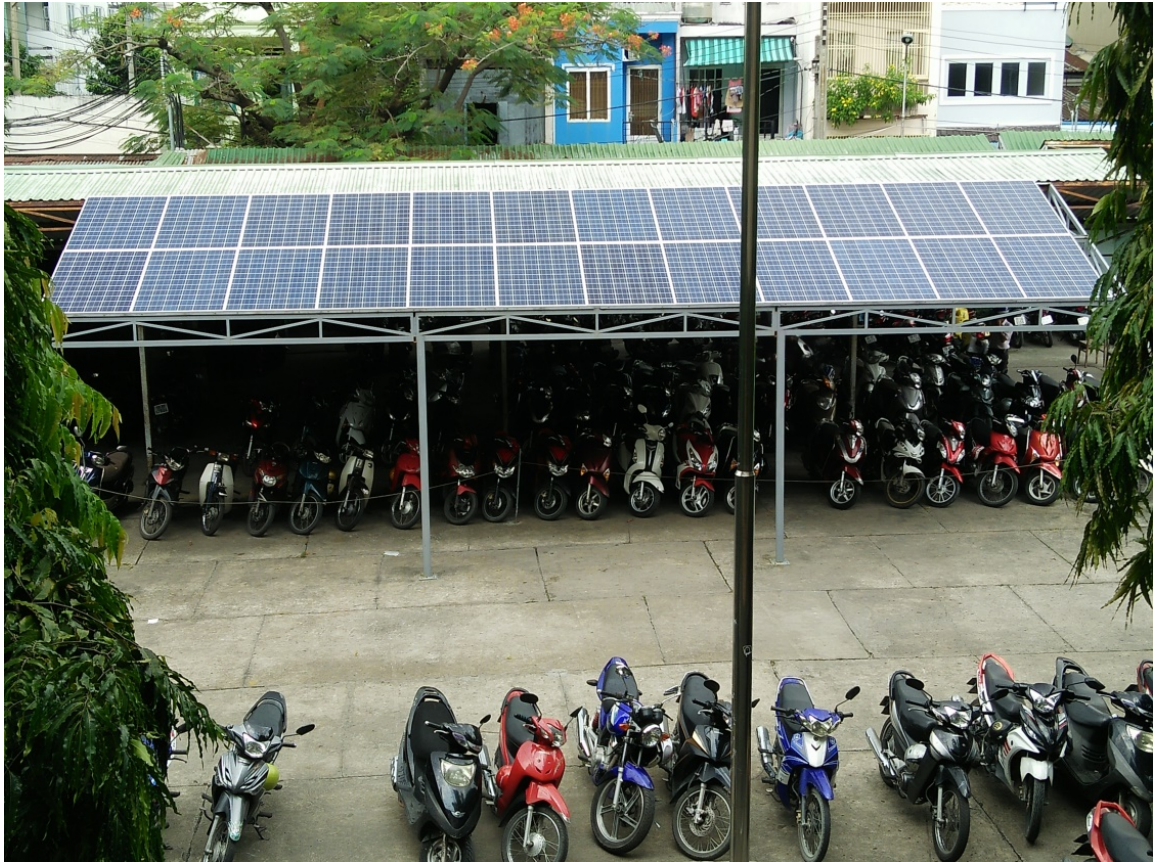
Hình 4: Hệ thống năng lượng mặt trời.
